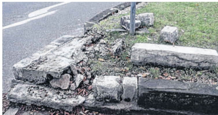
Gefahrenpunkt am Fußgängerübergang: die erneut ruinierte Ecke im Bereich Am Thie in Eppendorf.
